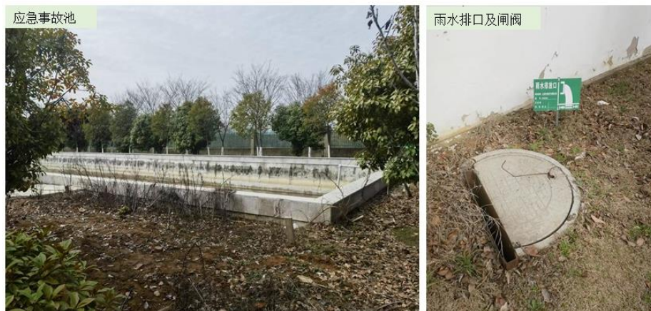
图 3.8-1 应急事故池及雨水排口闸阀
